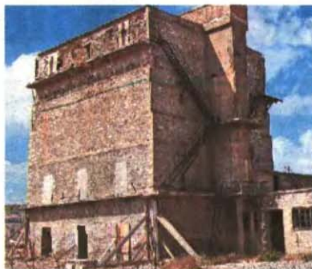
ΤΟ ΚΤΙΡΙΟ του Κονοφάγου με τους 150 τόνους άκρως επικίνδυνων τοξικών ουσιών, στο Λαύριο, άρασε να διαρρέει στο περιβάλλον τη μόλυνση. Ήδη, τα νήπια της περιοχής, εμφανίζουν «αερίεργα» συμπτώματα. Μετά, την ανάραισά τους, γιατί θα βρέξει ο καρκίνος
